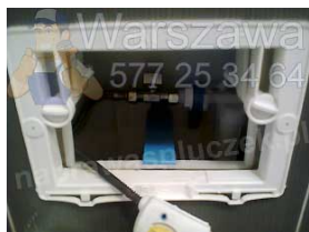
spluczka podtynkowa nie pobiera wody
